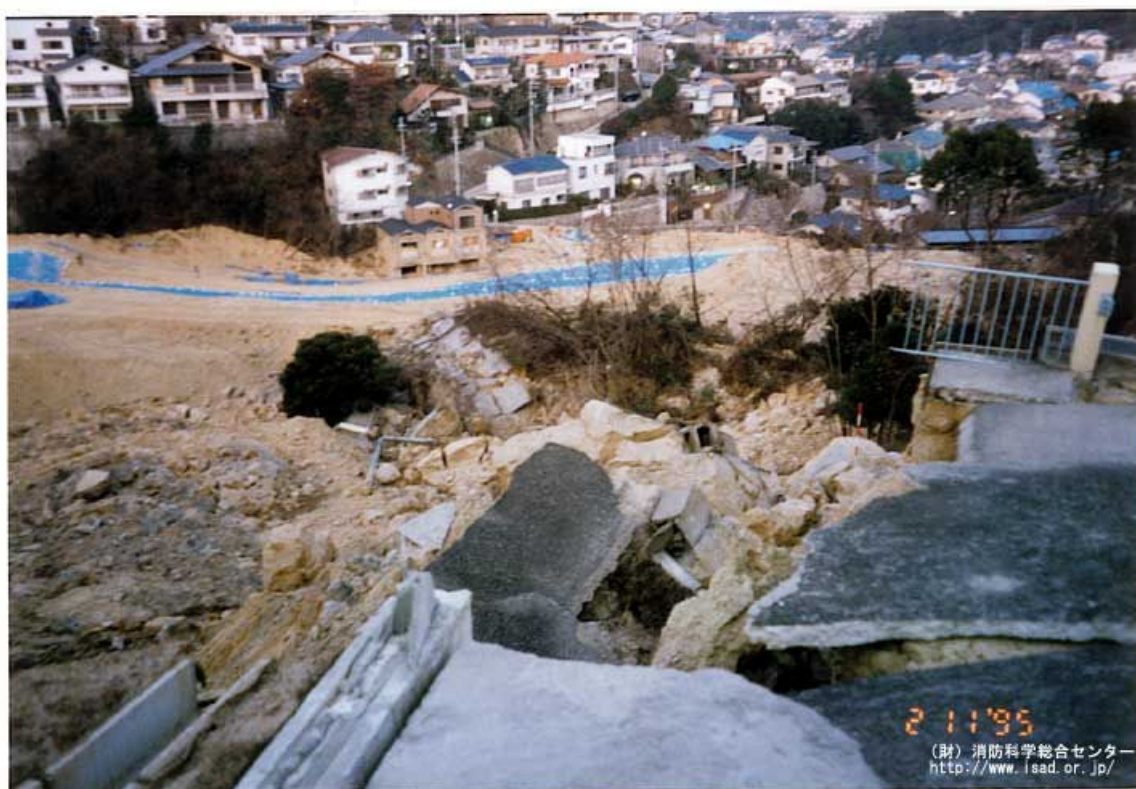
地震による地すべり被害の様子（西宮市仁川） 阪神淡路大震災（1995.1.17 震度7 M7.3） （財団法人消防科学総合センター提供）
